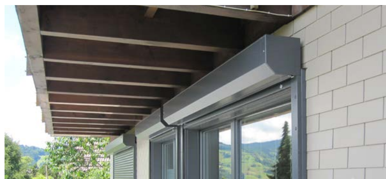
Solution élégante d'installation ultérieure au rez-de-chaussée
